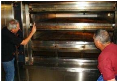
Die Backöfen sind mit Holzpellets beheizbar.
